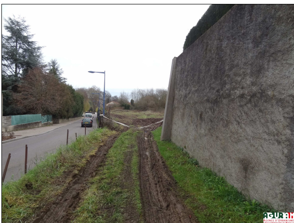
L'accès actuel est très insuffisant
